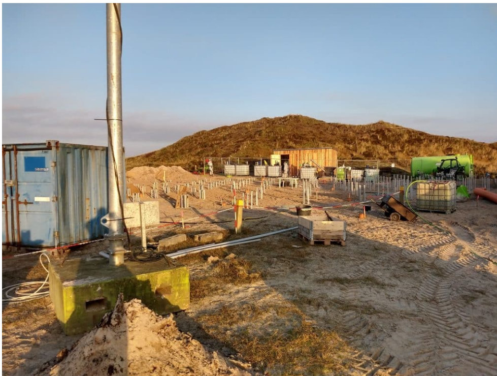
Site contaminé de Kærgård sur la côte ouest du Danemark. Photo prise en 2019. Installations pour le traitement in-situ (Léa Lévy).
