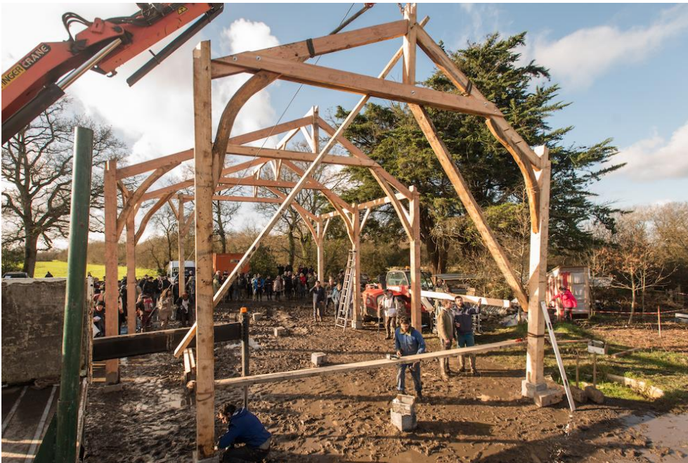
Un chantier collectif sur la zad de Notre-Dame-des-Landes en janvier 2020. © Yves Monteil / Reporterre
